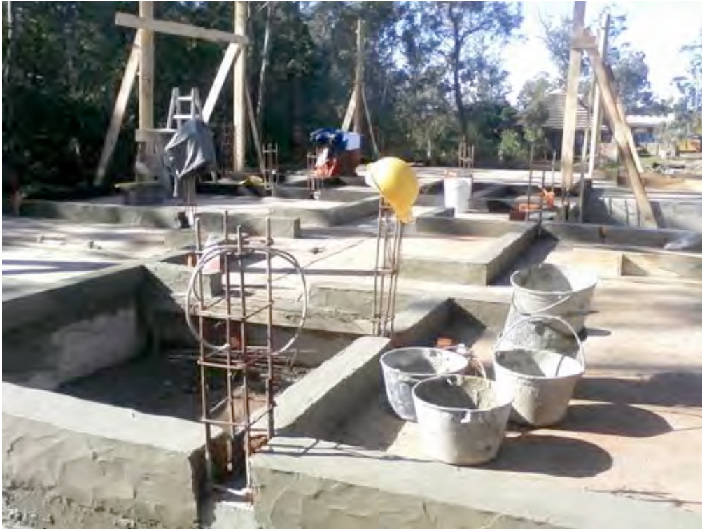
CAJÓN HIDRÓFUGO EN SECTOR B1.
